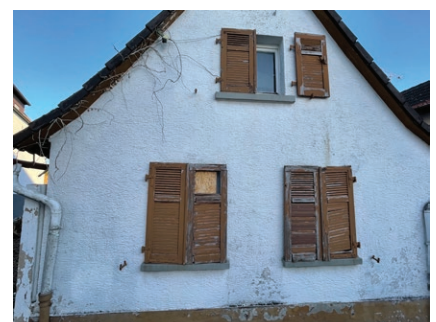
4.36 Verfallende Bausubstanz im Ortskern von Münster
